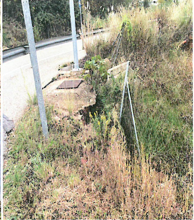
Fotografia 6: Detall del paviment amb risc de caiguda (accés a peu)
