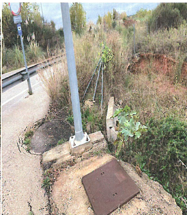
Fotografia 4: Accés a peu (Ferm afectat per estat esllavissades).
