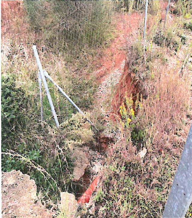
Fotografia 5: Zona d'accés a peu (esllavissada i tanca perimetral malmesa)
