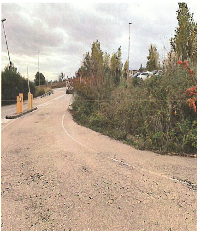
Fotografia 3: Asfalt i marques viàries en mal i fanal caigut
